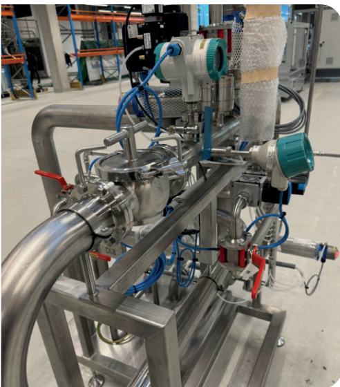
Molchstation zum Fangen und Zurücksenden des Molches in ATEX-Ausführung in einer Reinigungsmittelproduktionsanlage
