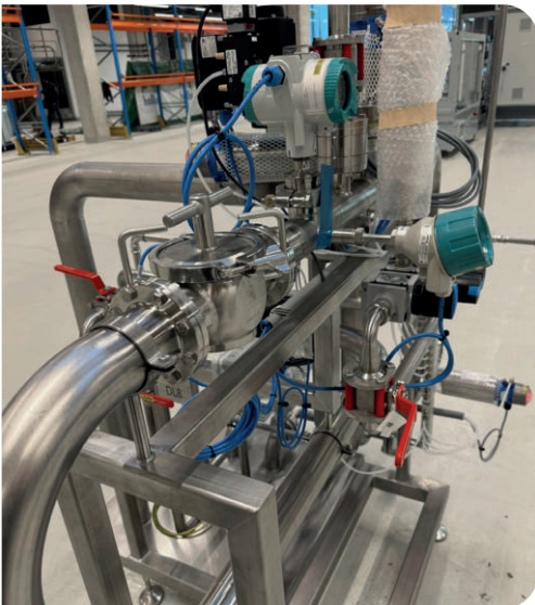
Stazione di pigging per la raccolta e il rinvio del pig in versione ATEX in un impianto di produzione di detergenti
